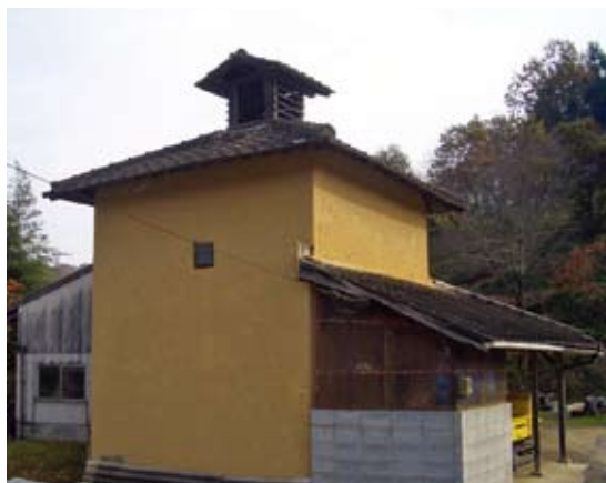
● 久米郡久米南町／昭和30年代前半の建設（西日本たばこ耕作組合提供）
